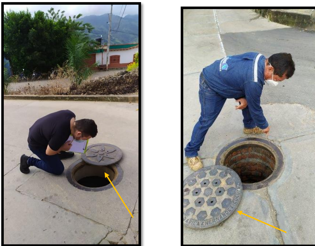
Figura 10 Estado de la Tapa del Pozo. Autor del proyecto.
