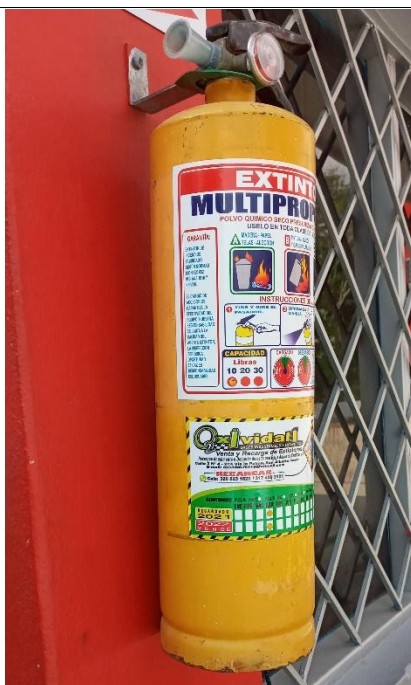
Fotografía N°5. Estado de los extintores
