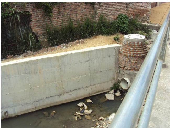
Figura 21. Colector vertimiento número 6 Barrio El Tejarito. ESPO S.A., informe de avance de obra (2012).
