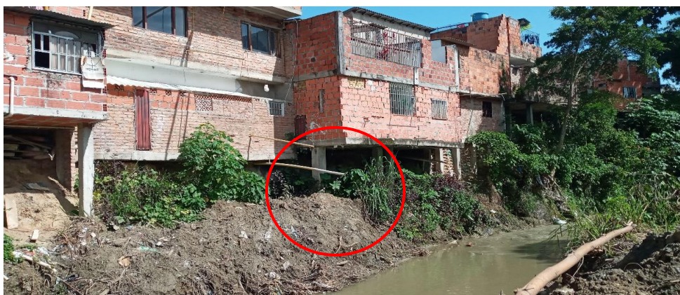
Figura 12. Puntos no conectados al alcantarillado. Autor, (2021).
