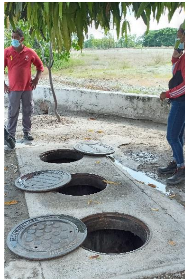
Fotografía N°4. Caja de Inspeccion
