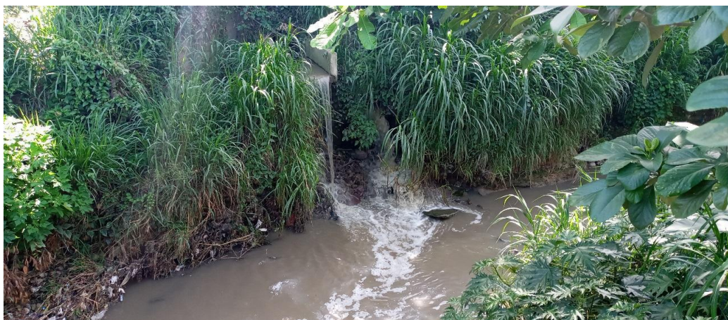
Figura 15. Vertimientos del Puente la Federación. Autor, (2021).
