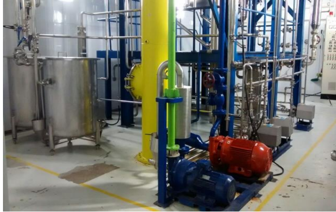
Figura 20. Evaporador. Fuente: Autor del proyecto (2020).
