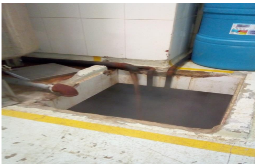
Figura 62. Tanque almacenamiento aguas negras. Fuente: Autor del proyecto (2020).
