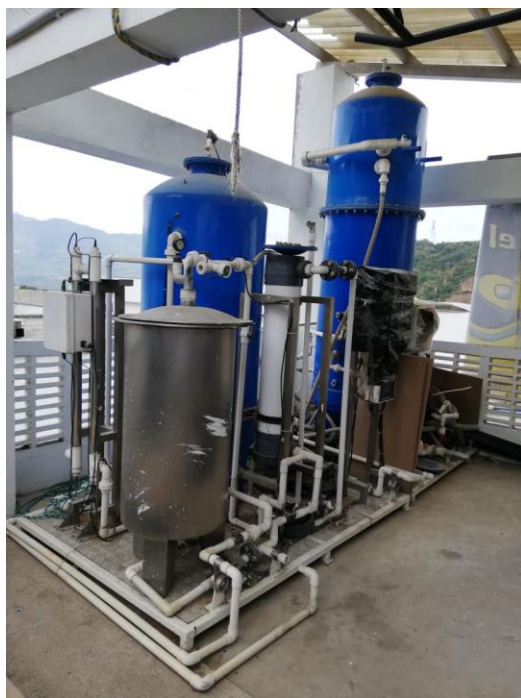
Figura 69. PTAR desarmada y almacenada. Fuente: Autor del proyecto (2020).
