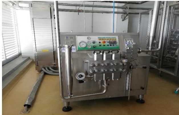
Figura 15. Homogenizadora. Fuente: Autor del proyecto (2020).
