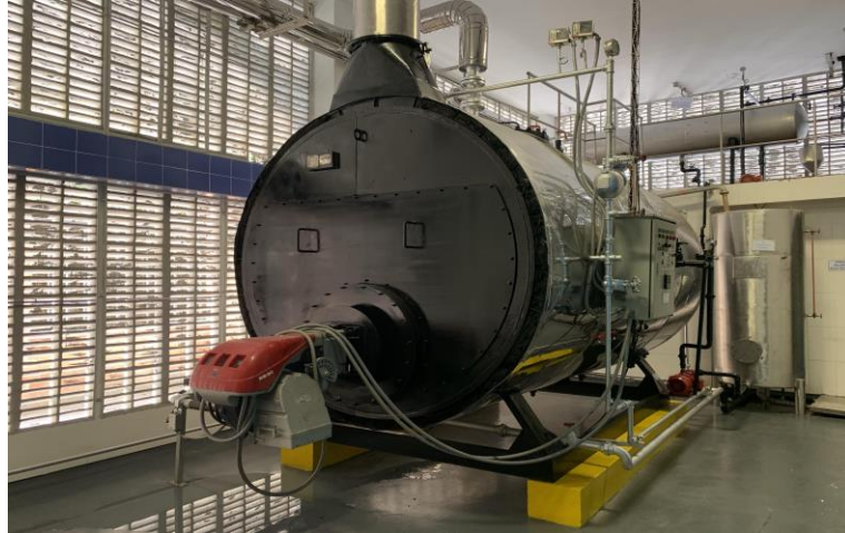
Figura 49. Caldera proceso pulverización. Fuente: Autor del proyecto (2020).
