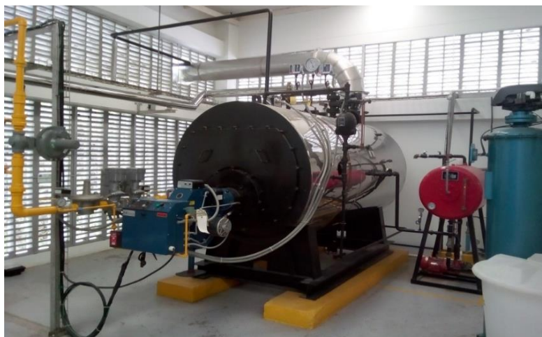
Figura 48. Caldera proceso de leche UHT. Fuente: Autor del proyecto (2020).
