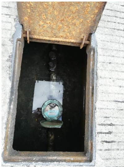
Figura 43. Contador de acueducto. Fuente: Autor del proyecto (2020).
