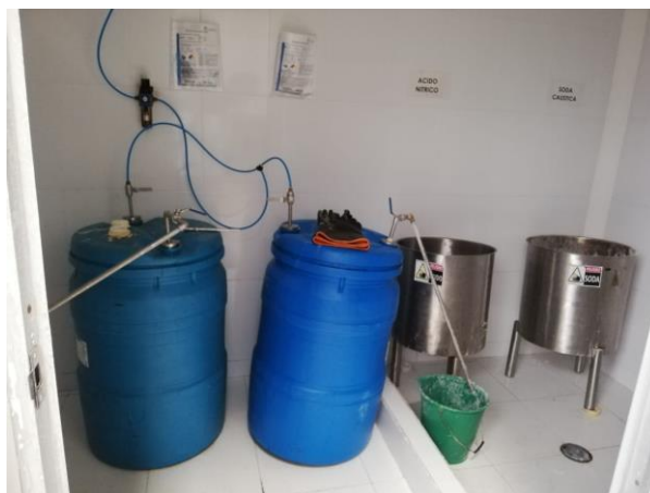
Figura 67. Almacenamiento de químicos. Fuente: Autor del proyecto (2020).
