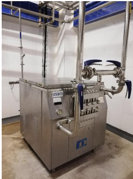
Figura 21. Homogenizadora. Fuente: Autor del proyecto (2020).
