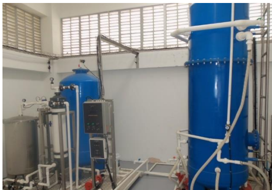
Figura 68. PTAR en funcionamiento. Fuente: INDUNILO S.A.S (2019).
