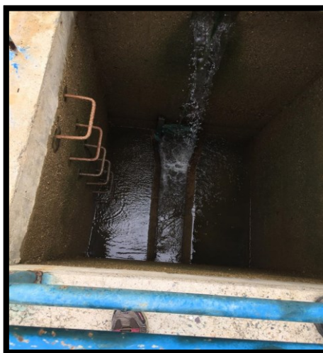
Figura 12. Unidades de filtración. Elaboración propia
