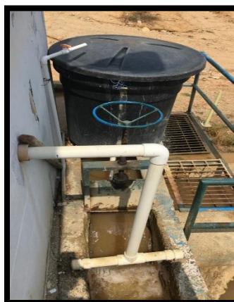
Figura 7. Tanque para dosificación manual del coagulante. Elaboración propia
