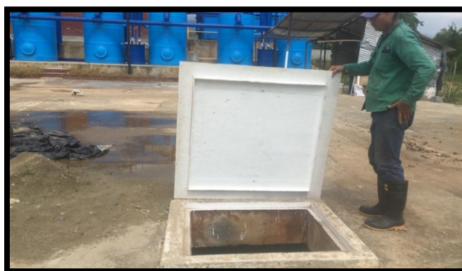
Figura 17. Tanque de almacenamiento. Elaboración propia
