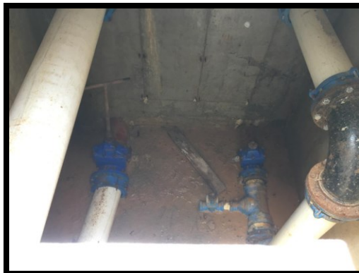
Figura 18. Conexiones con el tanque de almacenamiento. Elaboración propia
