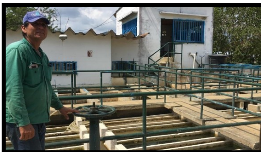
Figura 11. Volanta al final de la unidad de sedimentación para el retiro de sedimentos. Elaboración propia
