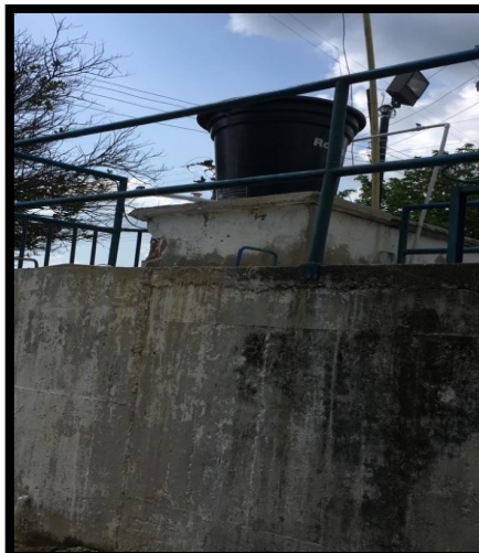
Figura 16. Tanque para dosificación de cloro manual en la caja de cloración a la salida de la PTAP. Elaboración propia
