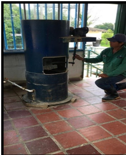
Figura 6. Aplicación de coagulante con uso de dosificador. Elaboración propia
