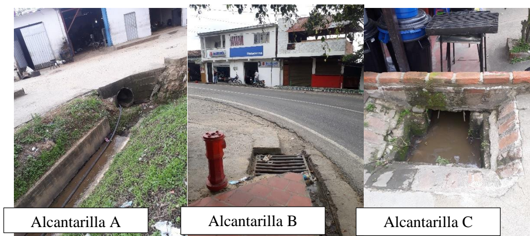
Figura 21. Alcantarillas en buen estado pero que se consideran en riesgo por derrame de sustancias peligrosas. Fuente. Elaboración propia (2019).
