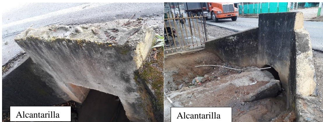
Figura 19. Alcantarillas en estado regular encontradas visiblemente en Abrego. Fuente. Elaboración propia (2019).
