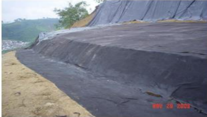
Figura 15. Impermeabilización de una zona inestable con geotextil no tejido y asfalto Fuente: http://www.bdigital.unal.edu.co
