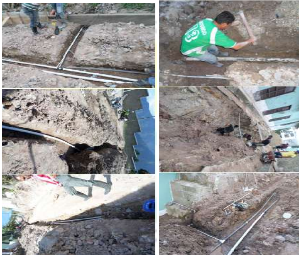
Figura 12. Modernización y Mantenimiento de la Red de Distribución (San Calixto)
