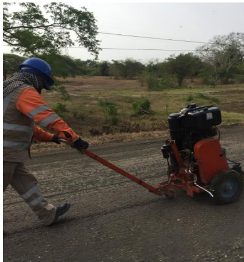
Fotografía 35. Ruteado de fisuras. Fuente: Autor (2019).
