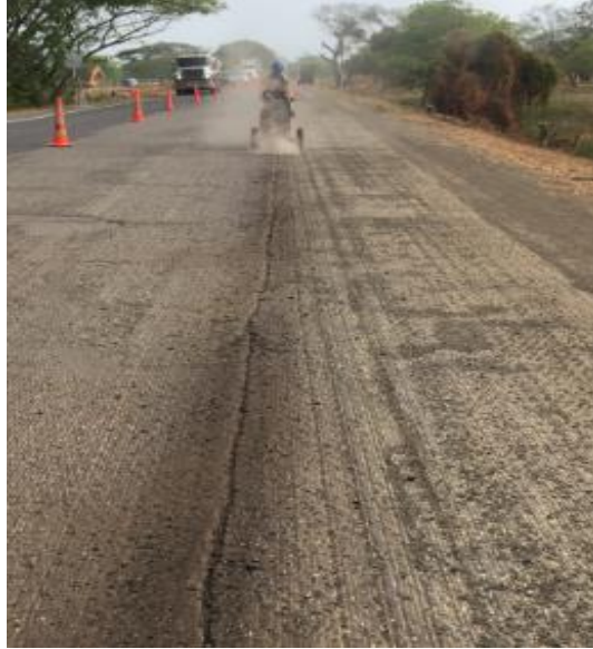
Fotografía 25. Fisura después de ser ruteada. Fuente: Autor del proyecto (2019).
