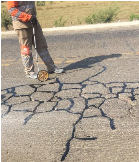
Fotografía 33. Medición de fisuras. Fuente: Autor del proyecto (2019).
