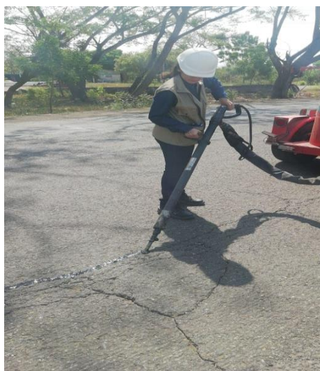
Fotografía 39. Sello de Fisuras en la Vía Calamar- Carreto, Bolívar. Fuente: Autor del proyecto (2019)
