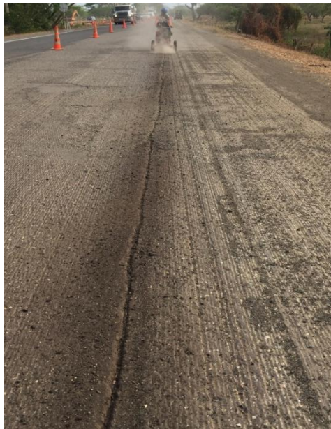
Fotografía 34. Fisura ruteada. Fuente: Autor del proyecto (2019).
