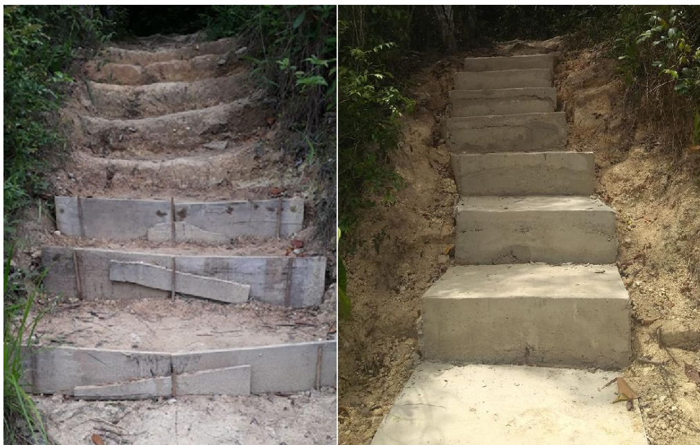
Imagen 11. Gradas del sendero en mal estado y su posterior remodelación. Fuente Autor de la pasantía, 2019.
