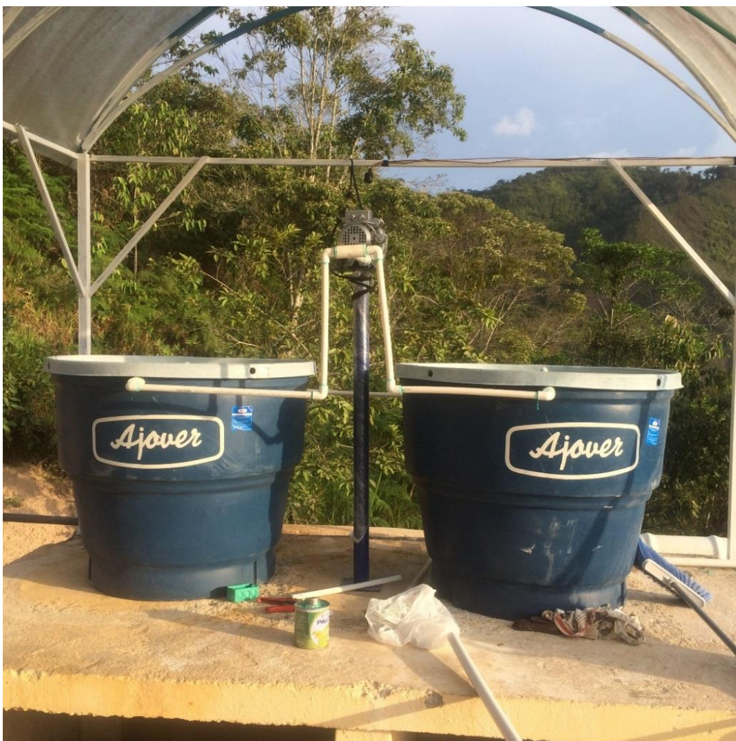
Figura 15. Tanques de Dosificación
