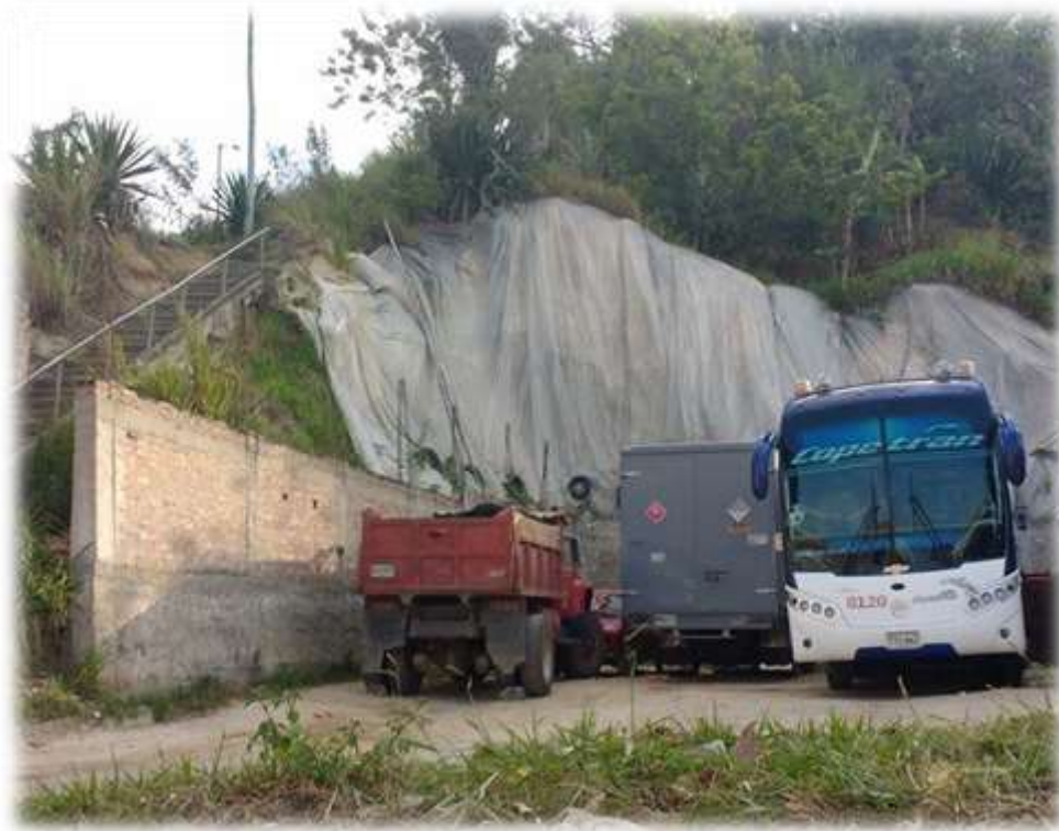
Fotografía 3. Punto susceptible a remoción en masa barrio el carretero.
