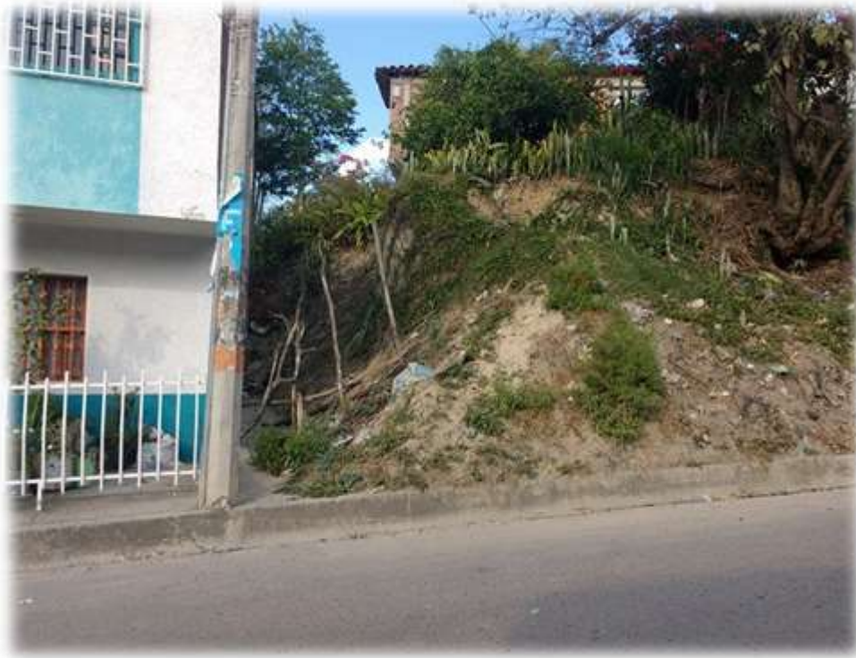
Fotografía 1. Punto susceptible a remoción en masa barrio el carretero.
