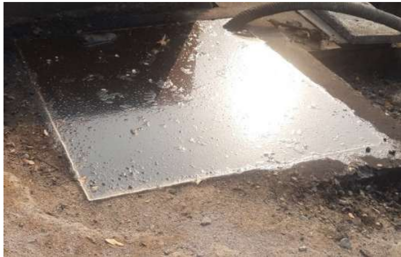
Caja de inspección rebosada de sangre (Generador de olores ofensivos)
