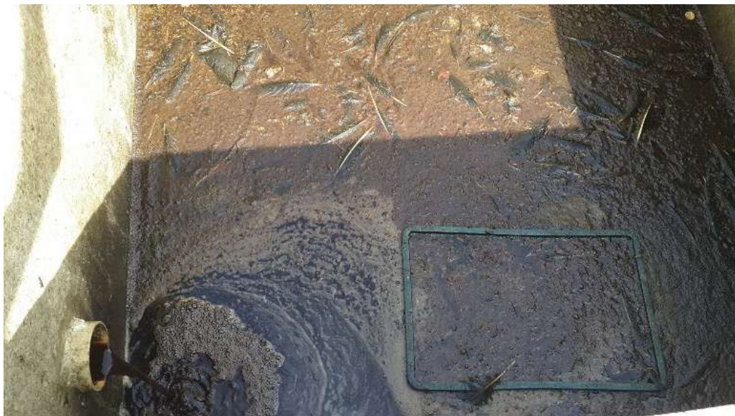
Parte interna de la PTAR colapsada
