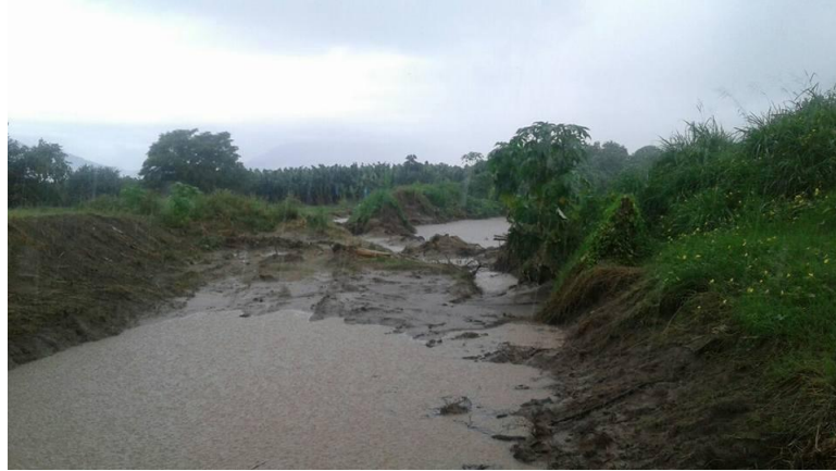
Figura 48 Punto geográfico de la quebrada la floresta donde se presenta ruptura de banco hidráulico Nota. Elaboración propia 2018
