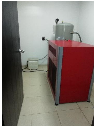
Ilustración 7 Cuarto de compresor odontología Fuente: Autor del proyecto
