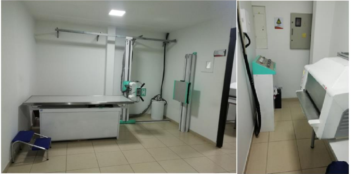
Ilustración 6 Cabina de Rx Fuente: Autor del proyecto
