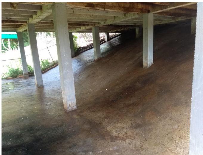
Foto 11. Resultado de una buena limpieza y desinfección
