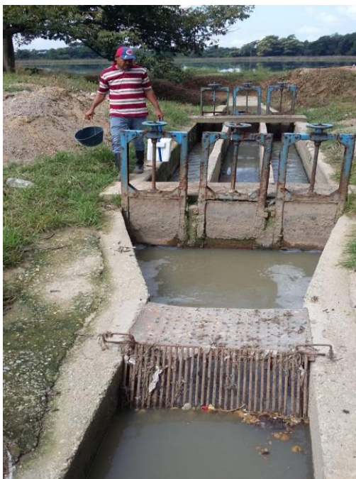
Figura 3. Estructura de entrada del sistema de tratamiento de aguas residuales.
