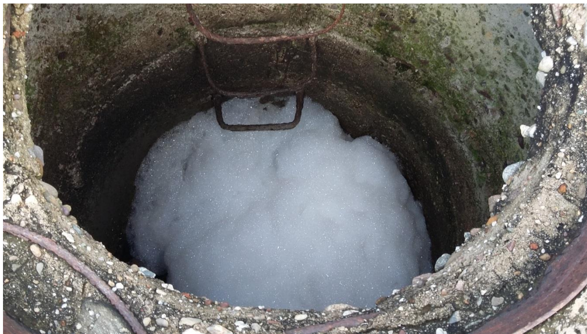
Figura 9. Pozos de inspección después del tratamiento secundario.
