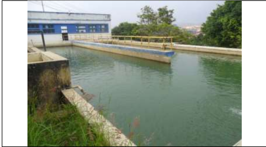
Fotografía 25 Proceso de sedimentación de la planta de tratamiento el Llanito.
