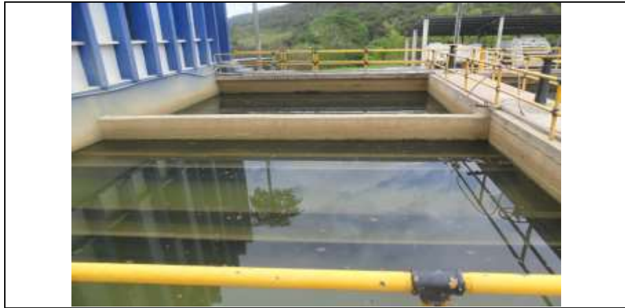
Fotografía 15. Sistema de filtración de la planta de tratamiento el Algodonal.
