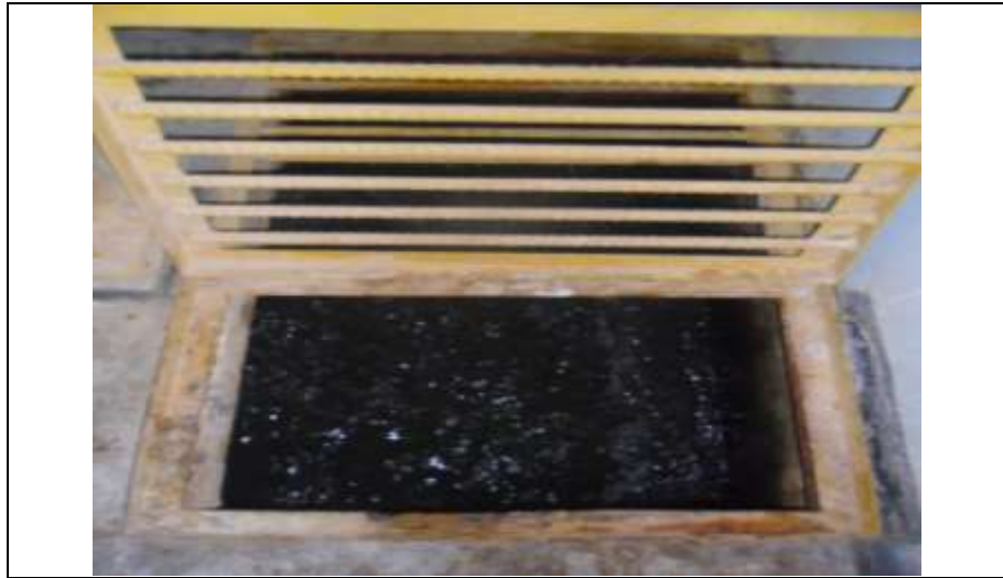
Fotografía 9. Cámara de aquietamiento de la planta de tratamiento el Algodonal.
