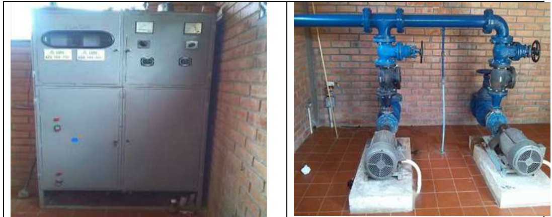
Fotografía 30. Sistema de bombeo del tanque almacenamiento de Cristo rey.
