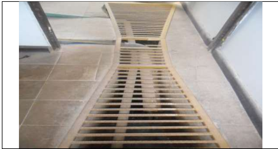
Fotografía 10. Canaleta parshall de la planta de tratamiento el Algodonal.
