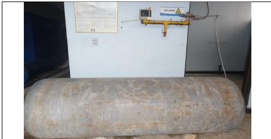
Fotografía 16. Proceso de cloración de la planta de tratamiento el Algodonal.
