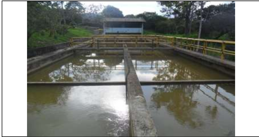
Fotografía 7. Desarenador de la planta de tratamiento el Algodonal.
