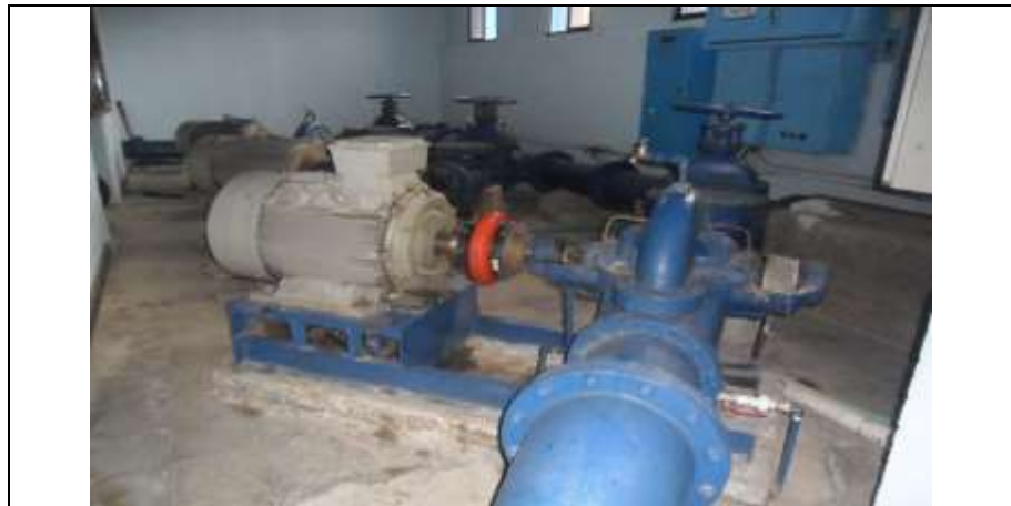
Fotografía 18. Sistema de distribución de la planta de tratamiento el Algodonal.
