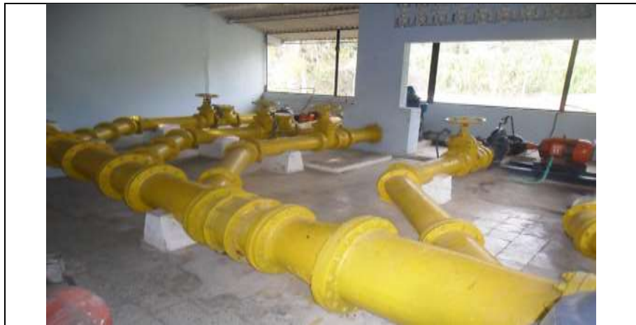
Fotografía 8. Estación de bombeo de la planta de tratamiento el Algodonal.
