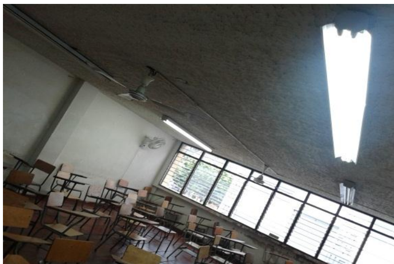
Figura 28 evidenciamos el mal uso de la energía artificial en uno de los salones del Edificio Semipesados, U.F.P.S, Sede colsag.
