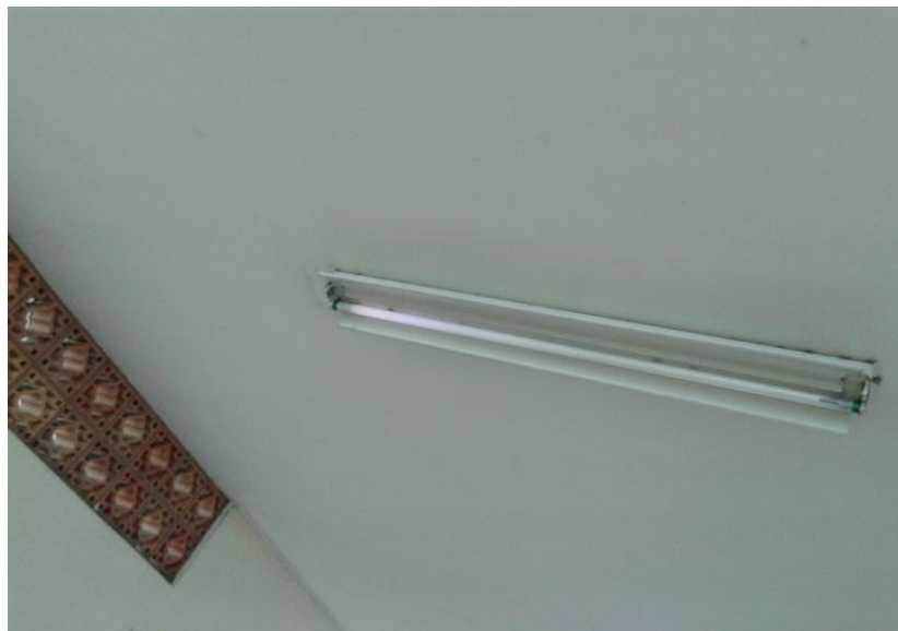
Figura 31 evidencia de laparas en mal estado profundizando el desperdicio del recurso energético.
