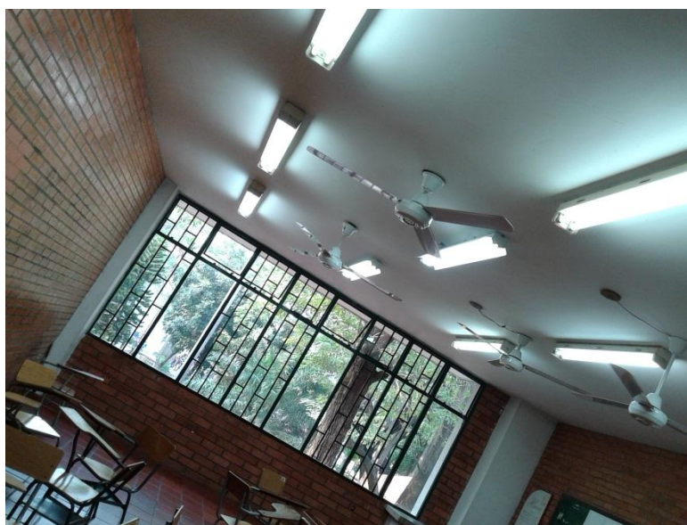
Figura 30 evidenciamos el mal uso de la energía artificial en uno de los salones del Edificio Aula General, U.F.P.S, Sede colsag
