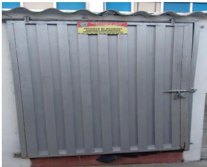
Fotografía 14. Depósito de residuos anatomopatológicos
