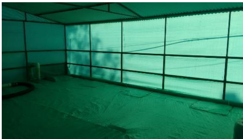
Fotografía 20. Interno de la planta de tratamiento de agua residual industrial PTARI
