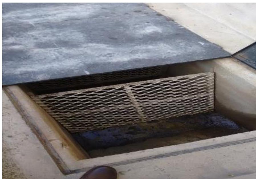
Fotografía 16. Caja de control para retención de solidos
