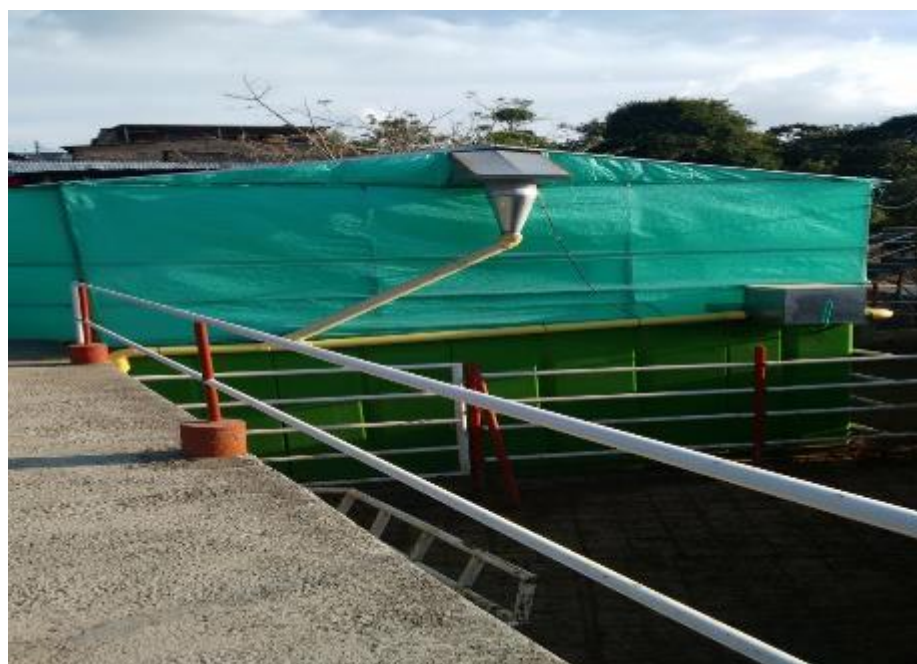
Fotografía 6. Extractores Industriales, Proceso de ventilación compartimento interno planta de tratamiento Fuente. Pasante del proyecto
