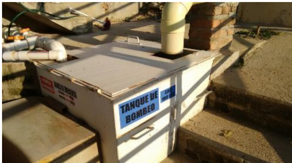
Fotografía 19. Tanque de bombeo
