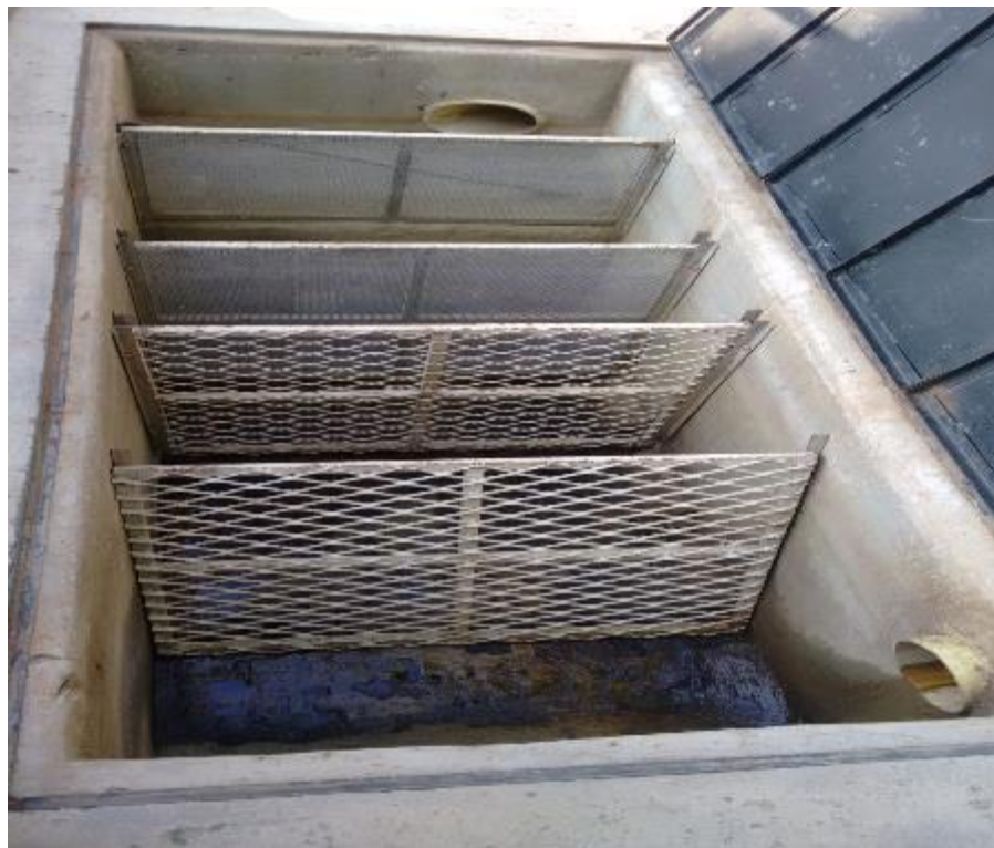
Fotografía 2. Caja de control para retención de sólidos
