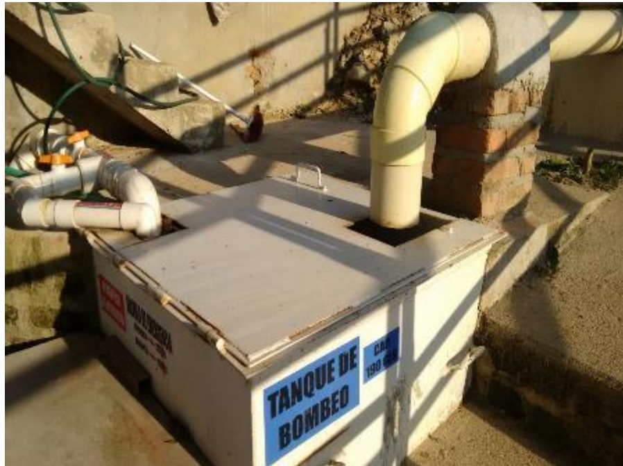
Fotografía 4. Caja de bombeo de fluidos
