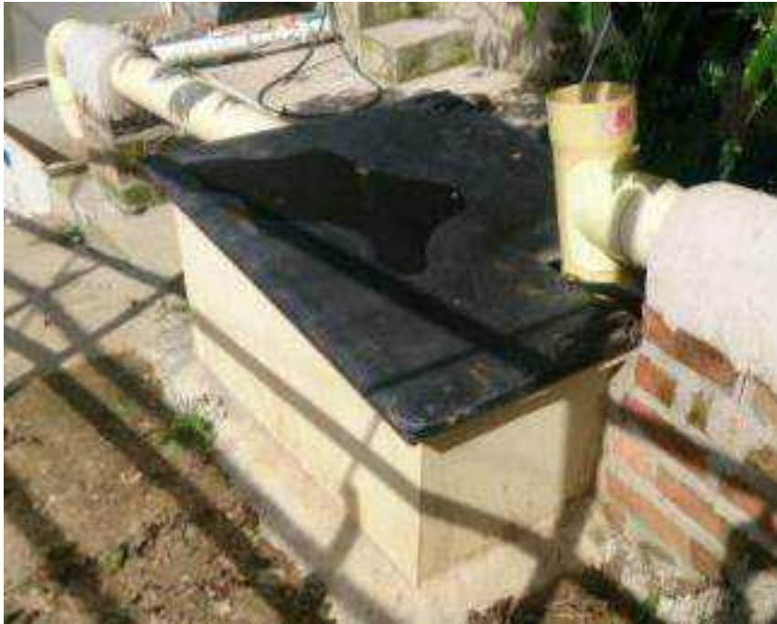
Fotografía 3. Trampa de grasa
