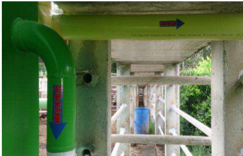
Fotografía 7. Línea de salida de fluidos a vertimientos (Vertical) y salida de Aire extraído de la planta (Horizontal)
