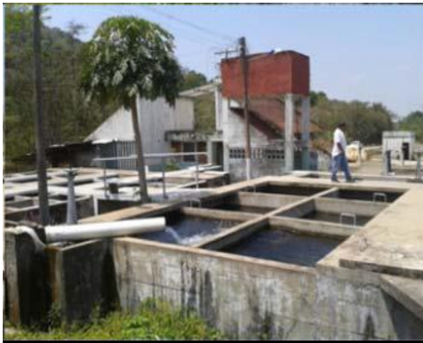
Fotografía 13. Entrada de agua a la Planta No. 2 Vista de los floculadores. Nótese la tubería por donde ingresa el agua a los floculadores.
