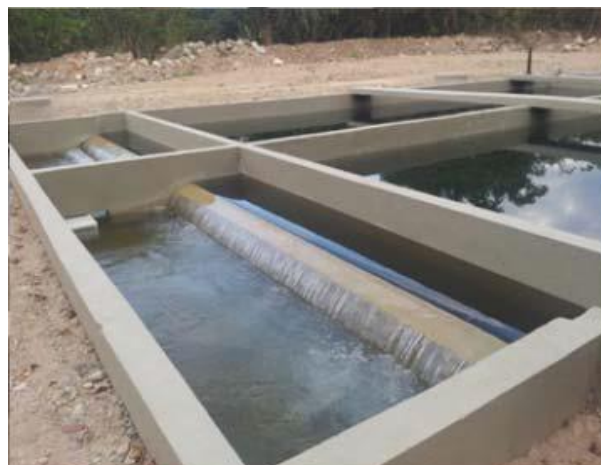
Fotografía 6. Control de salida de los desarenadores.
