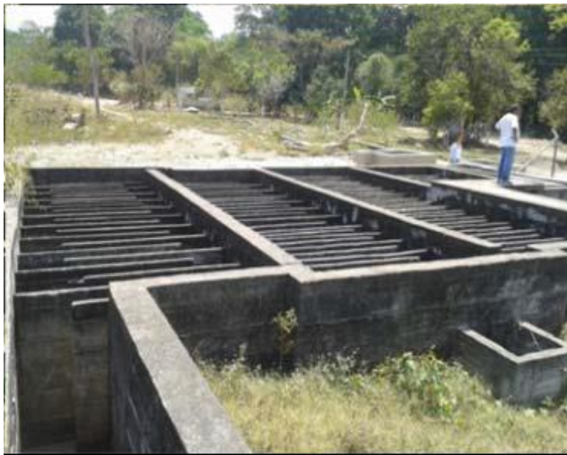
Fotografía 16. Floculador hidráulico horizontal de la Planta No. 3. Vista hacia aguas arriba.
