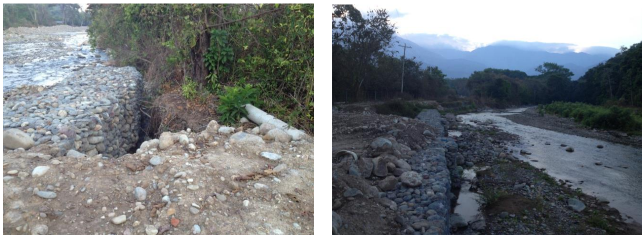
Fotografía 10. Detalles procesos de socavación de orillas e intervención del cauce a 250 m. abajo Aproximadamente de la planta.
