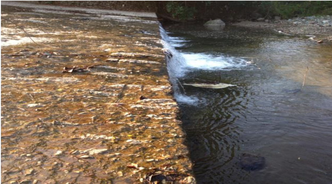
Fotografía 7. Socavación profunda a la salida de la estructura de captación, nótese la Profundización del cauce.
