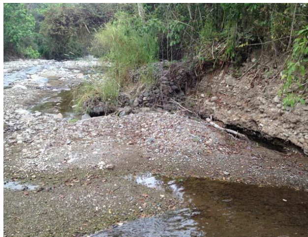
Fotografía 9. Detalles de inestabilidad de taludes
