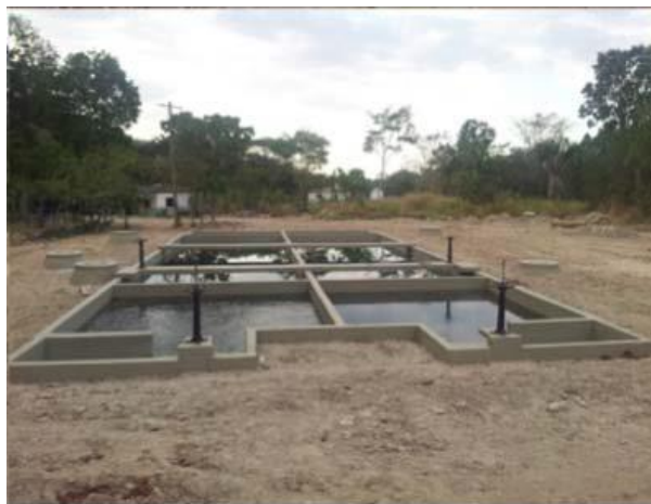
Fotografía 5. Sistema desarenador con dos módulos. Vista hacia abajo.
