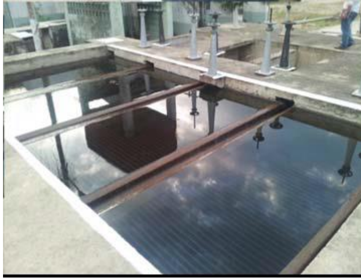
Fotografía 15. Sedimentadores de placas paralelas en Planta No. 2
