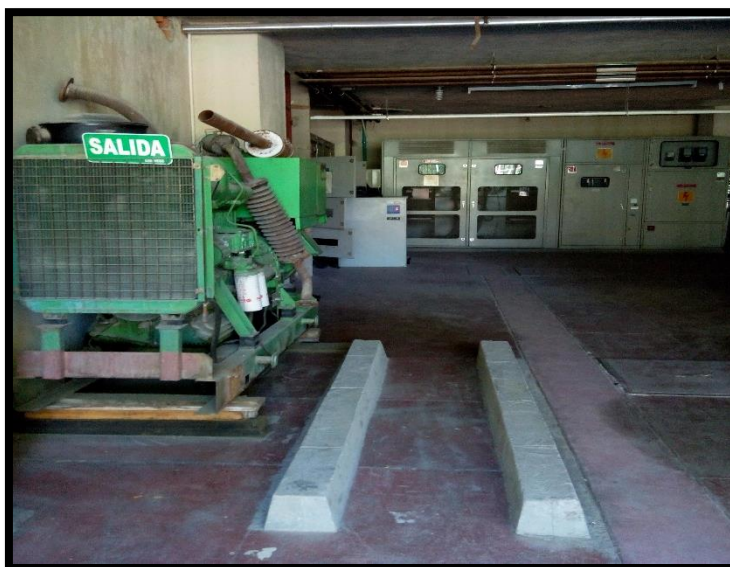
Fotografía 7. Generador eléctrico de emergencia en des-huso.
