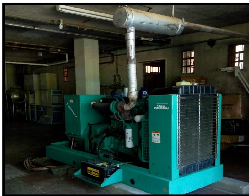
Fotografía 8. Generador eléctrico de emergencia.
