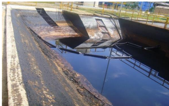
Figura 8. Visita realizada Estación Gala, Sabana de Torres
