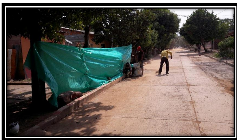
Fotografía 28. Barrido de Vías
