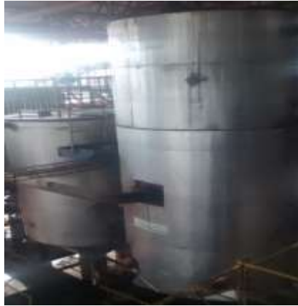
Fotografía 7. Tanques de sedimentación
