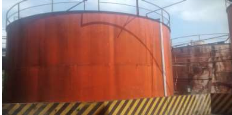
Fotografía 9. Tanque de almacenamiento
