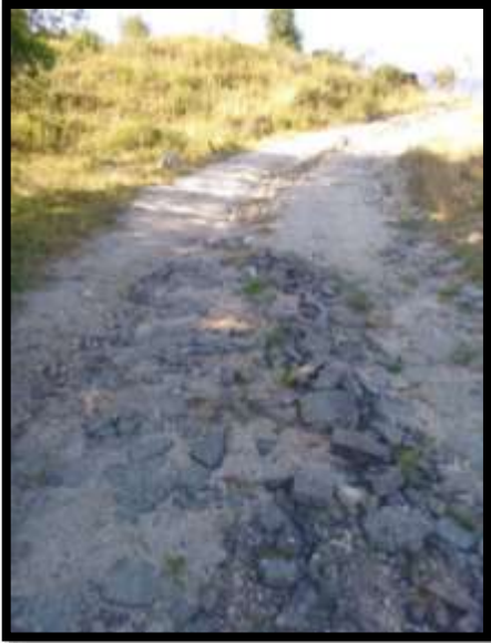
Fotografía 10. Vía de acceso sector Guayabal sin mantenimiento
