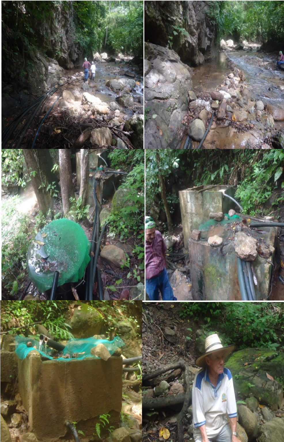
Desarenador existente, totalmente artesanal no brinda garantías en cuanto a calidad del agua para consumo humano.
