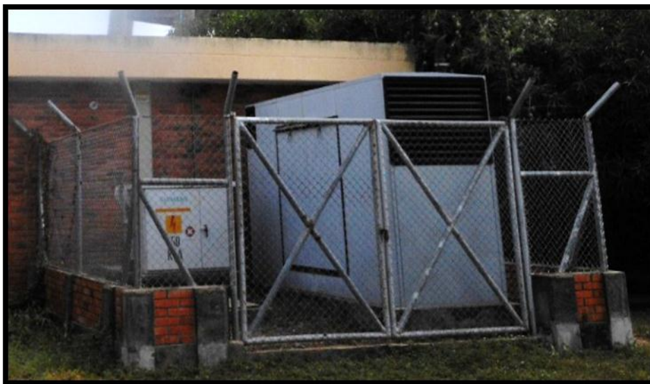
Fotografía 8. Planta de emergencia de la ptap
