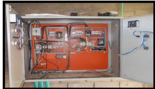
Fotografía 3. Tablero eléctrico pozo No. 3
