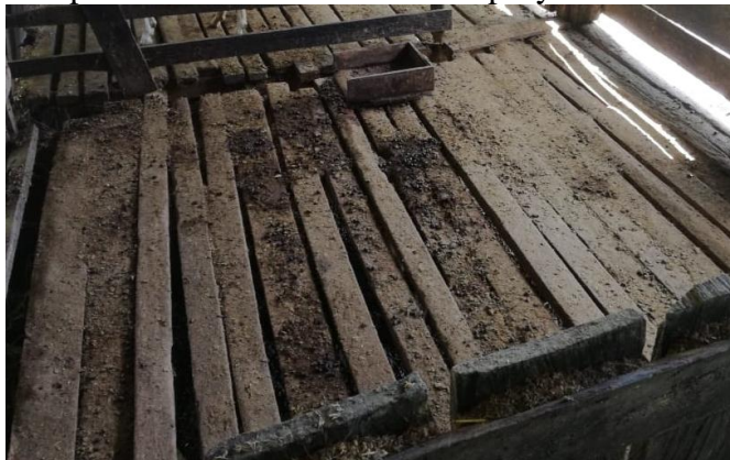
Figura 32. Pisos en mal estado y con mala limpieza. Fuente Autor del proyecto
