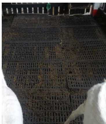
Figura 14. Condición regular de pisos y en estado de suciedad. Fuente (Autor, 2019)
