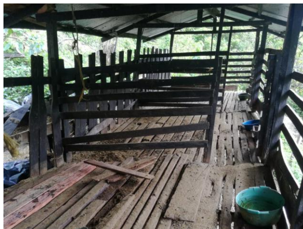
Figura 39. Instalaciones en mal estado. Fuente Autor del proyecto
