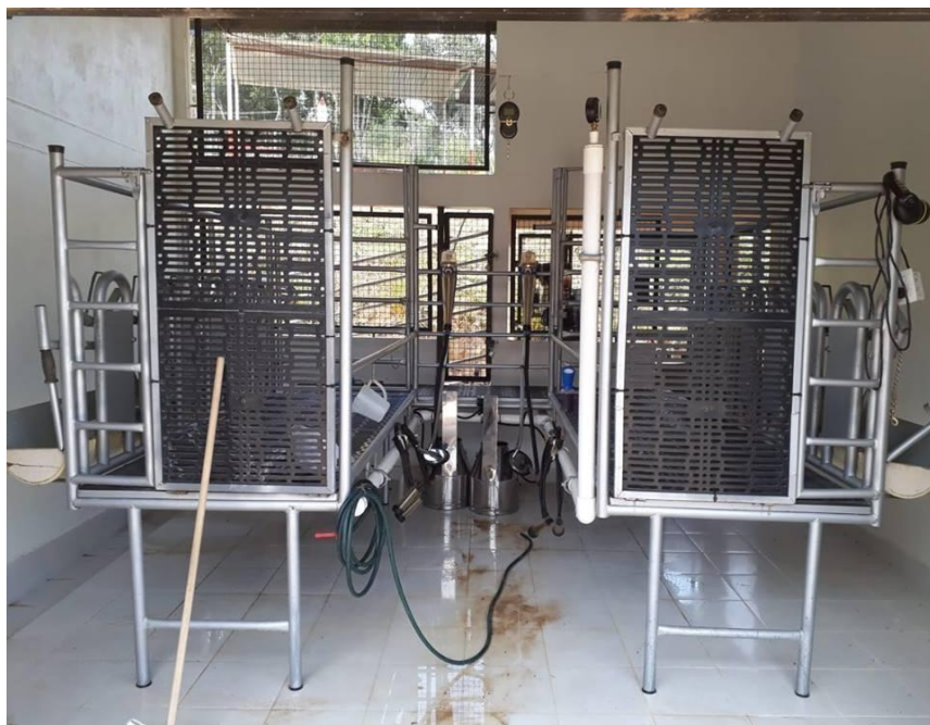
Figura 4. Instalación de ordeño.
