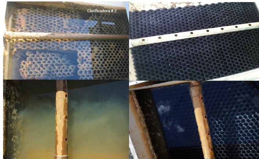
Figura 13. Comparación paneles iniciales vs actuales.
