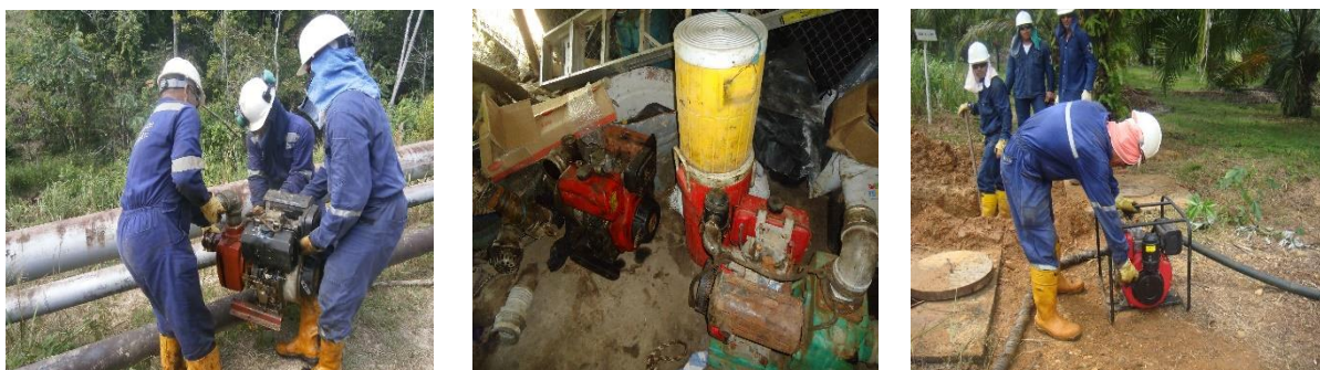
Figura 26. Inspección de motobombas
