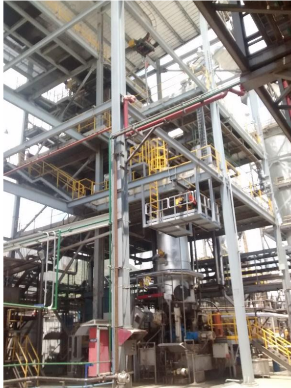
Figura 9. Torre de Refinación. Fuente: Autor del proyecto.
