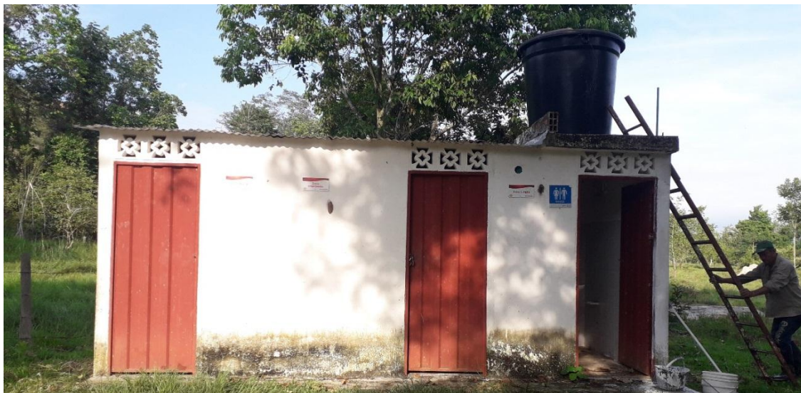
Figura 5. Batería sanitaria sin uso Fuente: Autor de informe
