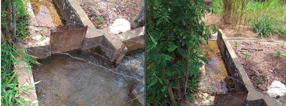
Figura 36. Compuerta de descarga libre
