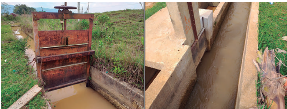
Figura 37. Compuerta principal - emergencia
