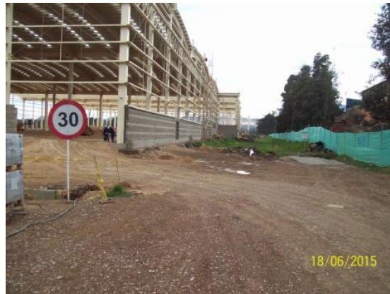
Foto 24. Asilamiento de excavaciones.
