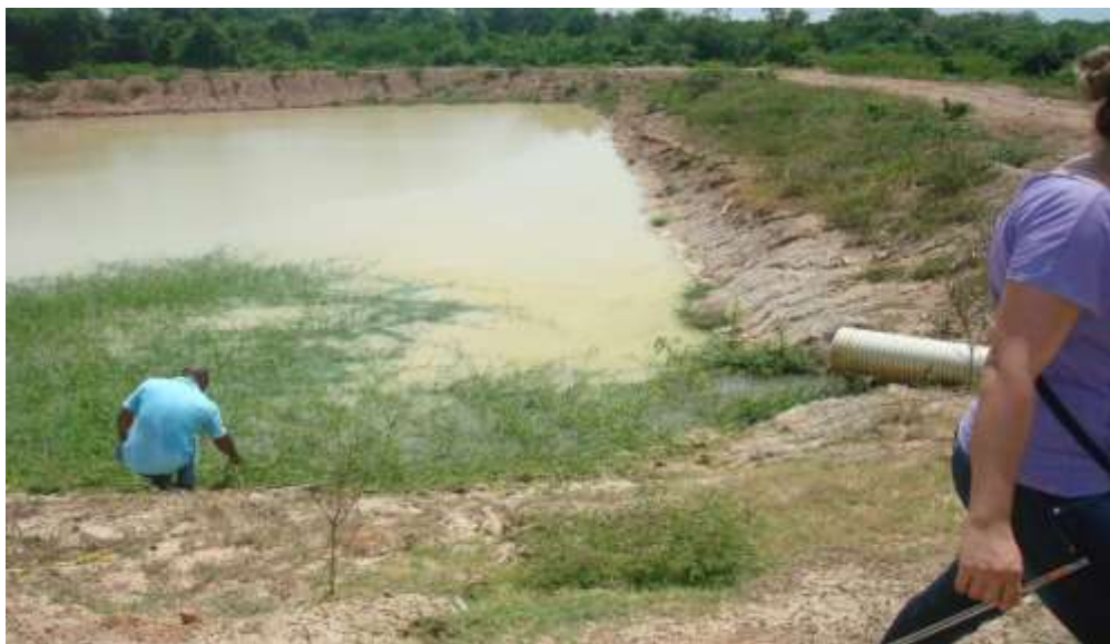
Figura 8. Laguna de oxidación Uno.
