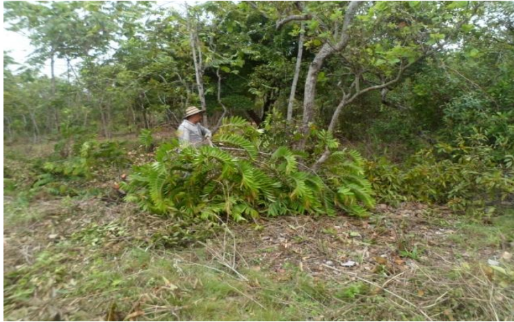
23 de septiembre de 2013, desmonte y limpieza del área donde se llevara a cabo el proyecto de la escombrera municipal.
