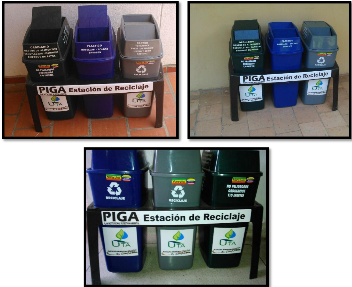
Figura 10. Registro Fotográfico Puntos Ecológicos Instalados
