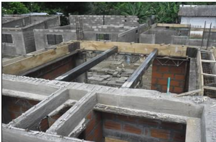
Figura 17. Vaciado del concreto de las vigas de carga Fuente: Autores del proyecto
