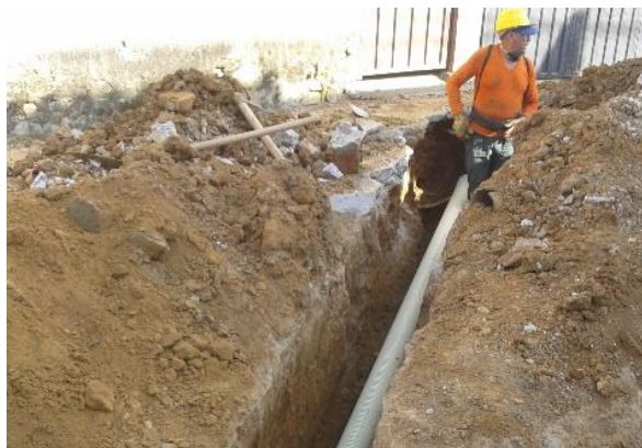
Figura 9. Tubería de PVC alcantarillado NOVAFORT D = 10", domiciliaria de alcantarillado.
