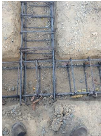
Figura 15. Figurado e instalación de acero de refuerzo para viga cemento. Fuente: Autores del Proyecto, 2016.
