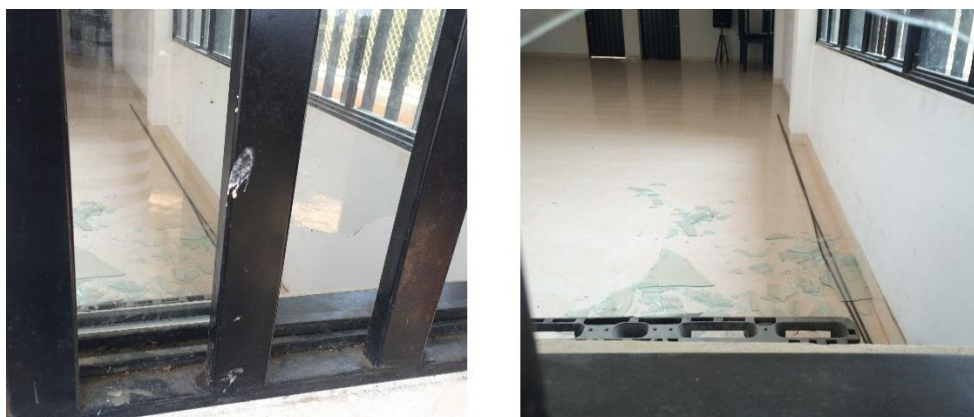
Figura 1. Estado actual del salón comunal corregimiento Banca Torcoroma Fuente: Autores del proyecto
