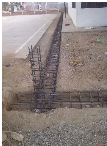
Figura 16. Figurado e instalación de acero de refuerzo para columnetas. Fuente: Autores del Proyecto, 2016.
