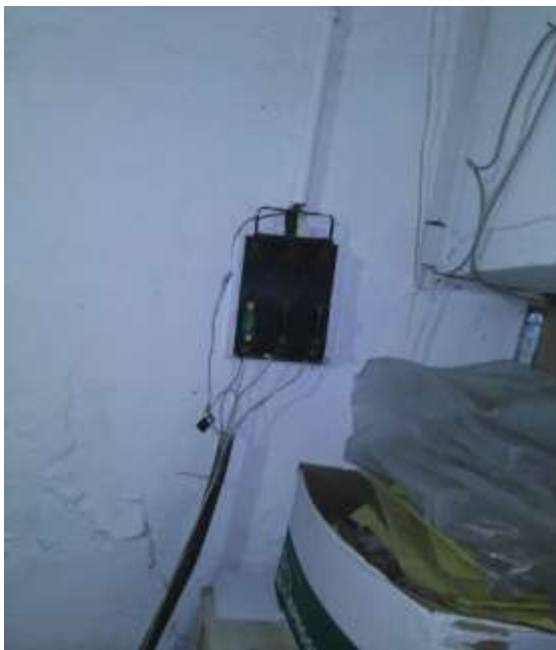
Cables eléctricos Fuente. Pasante
