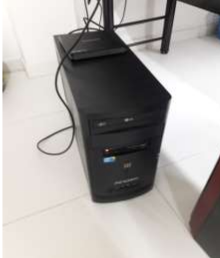
Figura 17. Servidor a utilizar para la central VoIP.
