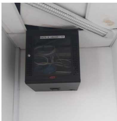
Figura 12 : Rack área de Rehabilitación E.S.E Hospital Emiro Quintero Cañizares.
