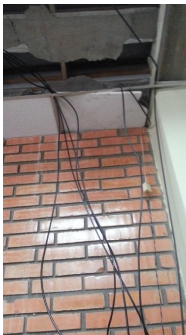
Figura 18. Cables de red sin normas de cableado estructurado
