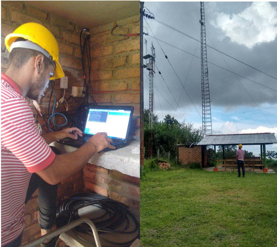
Soporte a antenas en Pueblo Nuevo.
