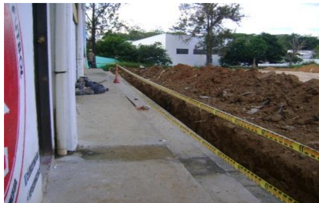
FOTO 6 CERRAMIENTO CON CINTA DE PELIGRO
