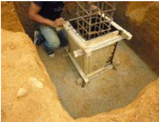
Fotografía 21. Casetón de pedestal
