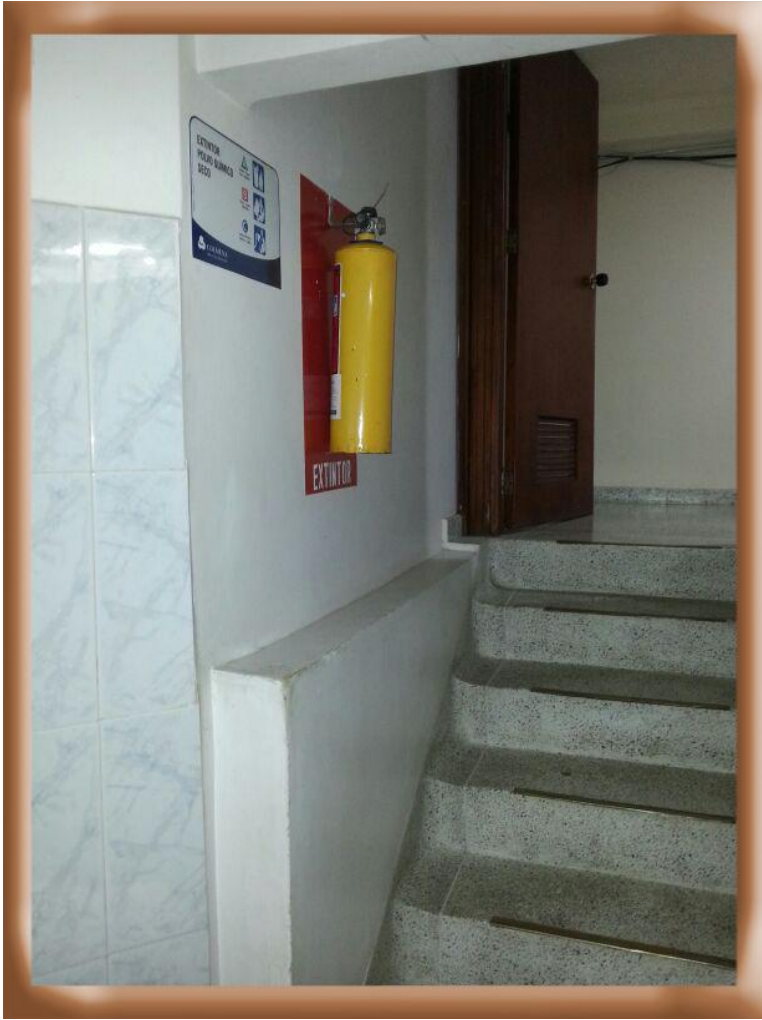
Foto 5. Extintor 2. Primer Piso.
