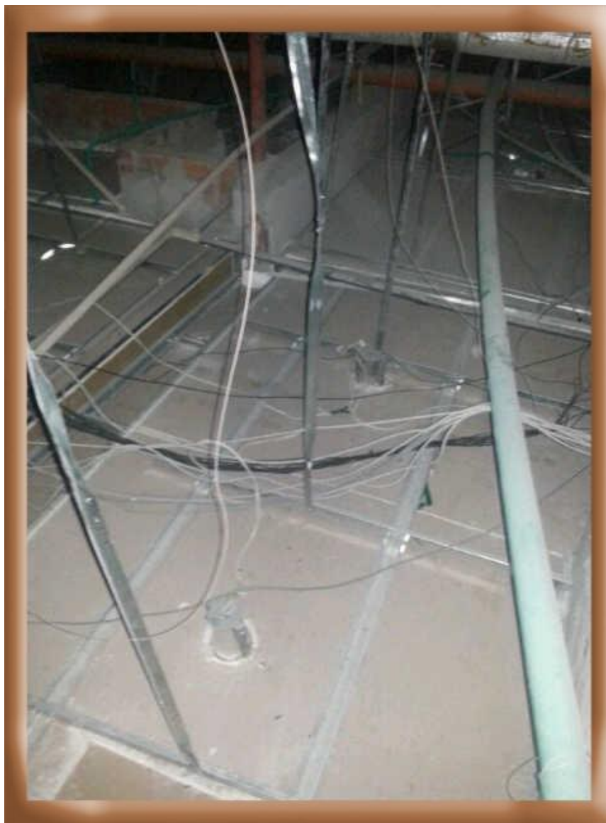
Foto 2. Cableado UTP Categoría 5E sobre techo falso Tercer piso
