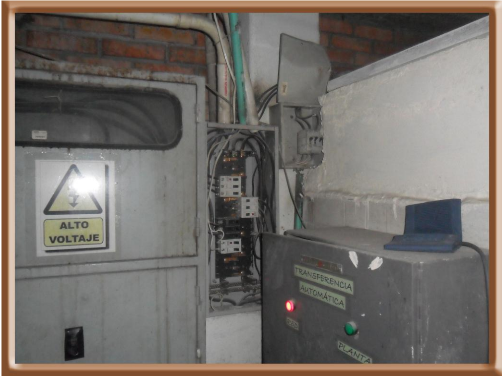
Foto EF003 : Conexión Eléctrica
