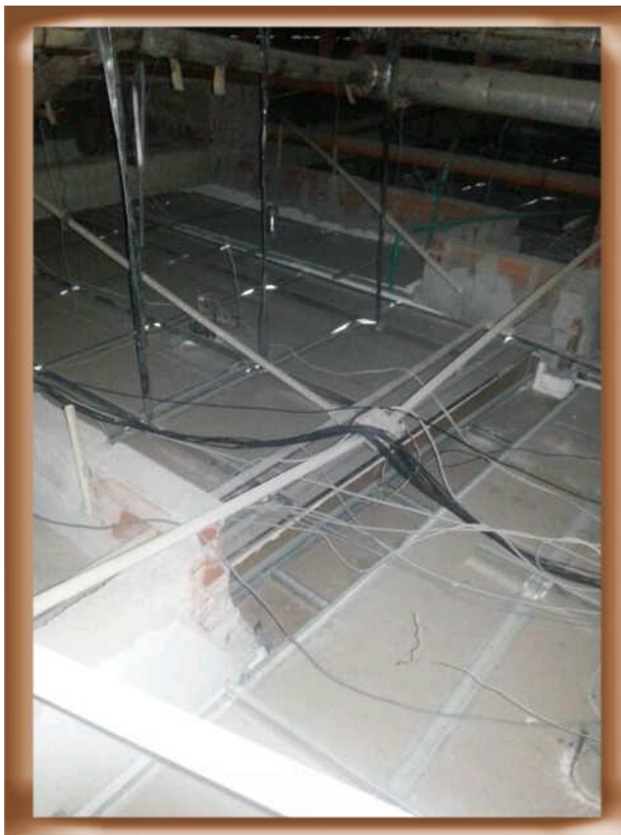
Foto 4. Cableado UTP Categoría 5E sobre techo falso Primer piso
