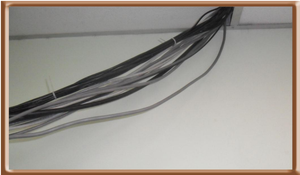
Foto EF011: Calidad del Cableado de Red
