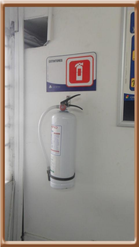
Foto EF002: Extintor
