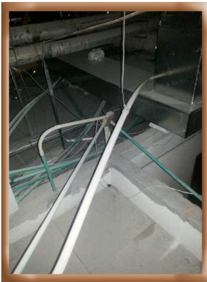
Foto 3. Cableado UTP Categoría 5E sobre techo falso Segundo piso
