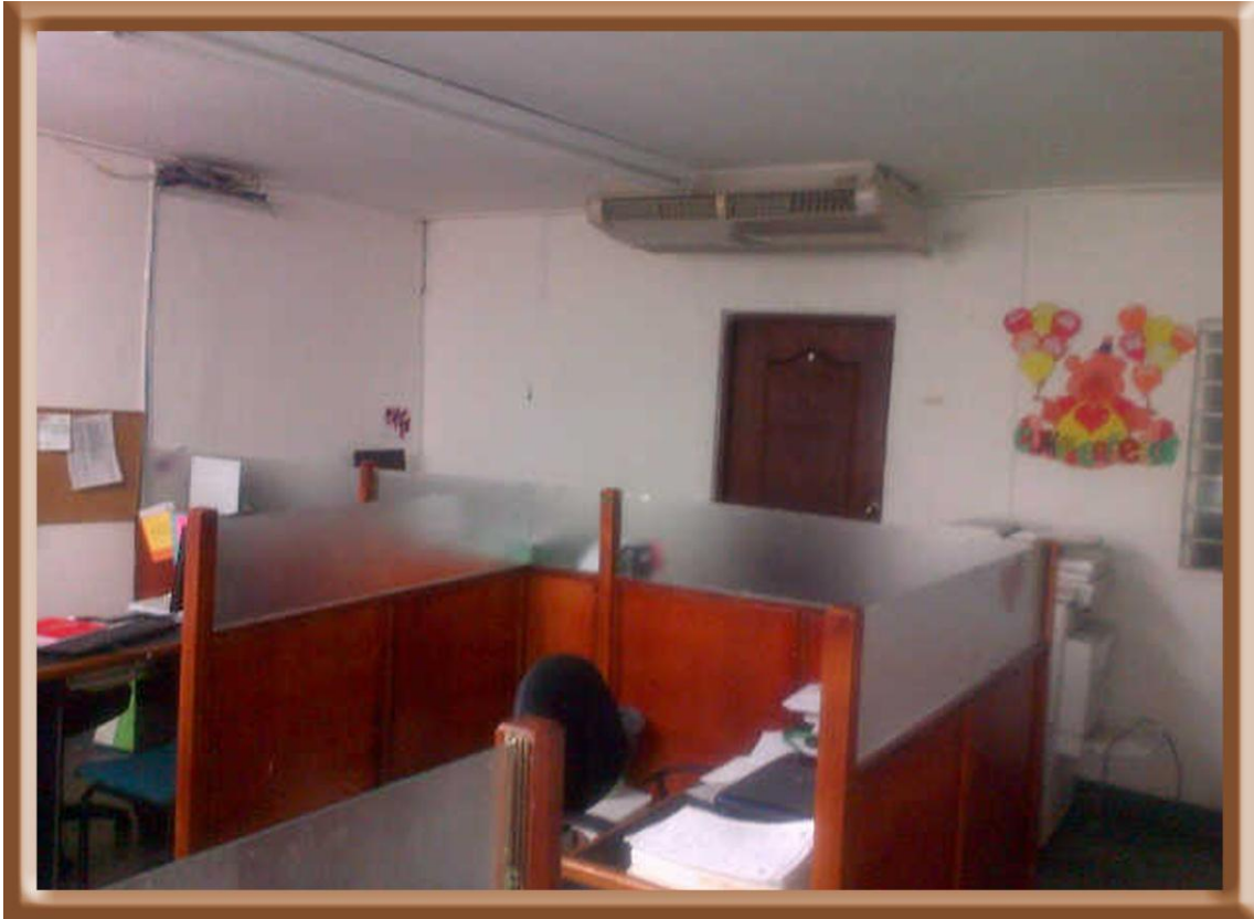
Foto EF001 . Aire Acondicionado
