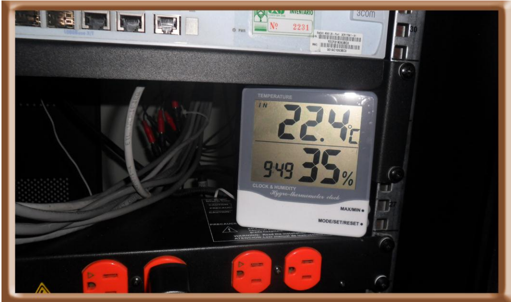
Foto EF010: Medidor de Temperatura del Rack
