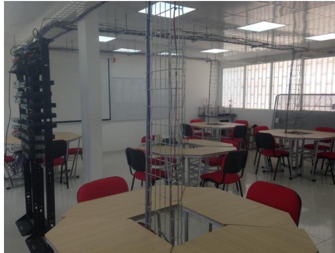
Figura 22. Laboratorio de redes y telecomunicaciones UFPSO
